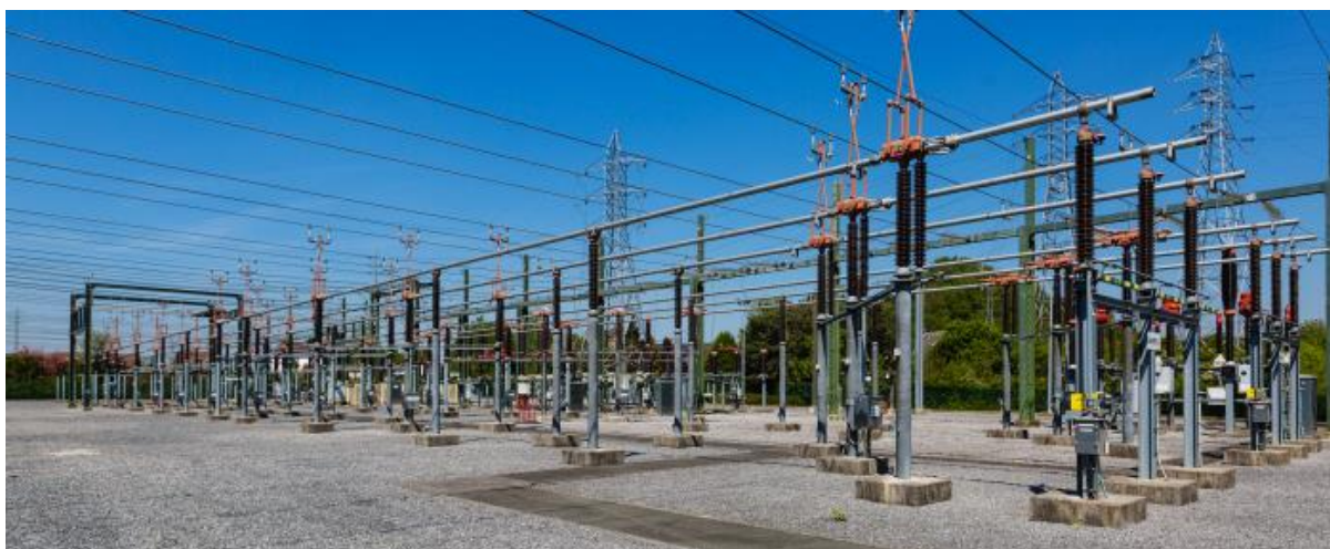
Figure 1.4 : sous-station 150 kV de type AIS
