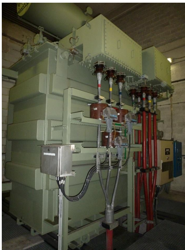
Figure 1.3 : câbles souterrains connectés sur un transformateur
