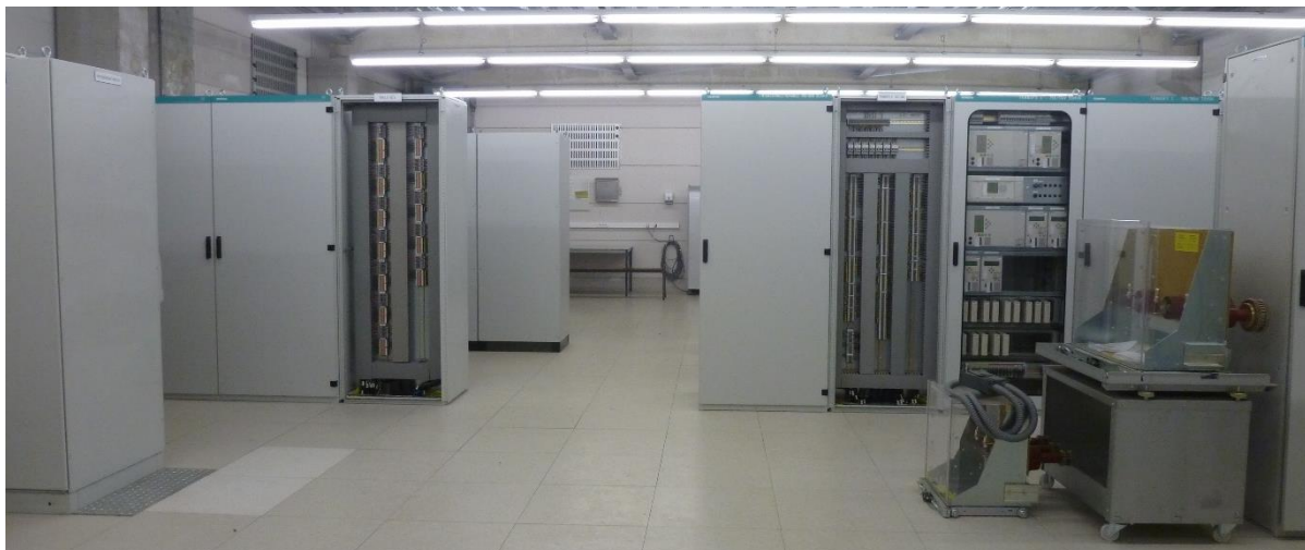
Figure 1.6 : équipements secondaires d'une sous-station
