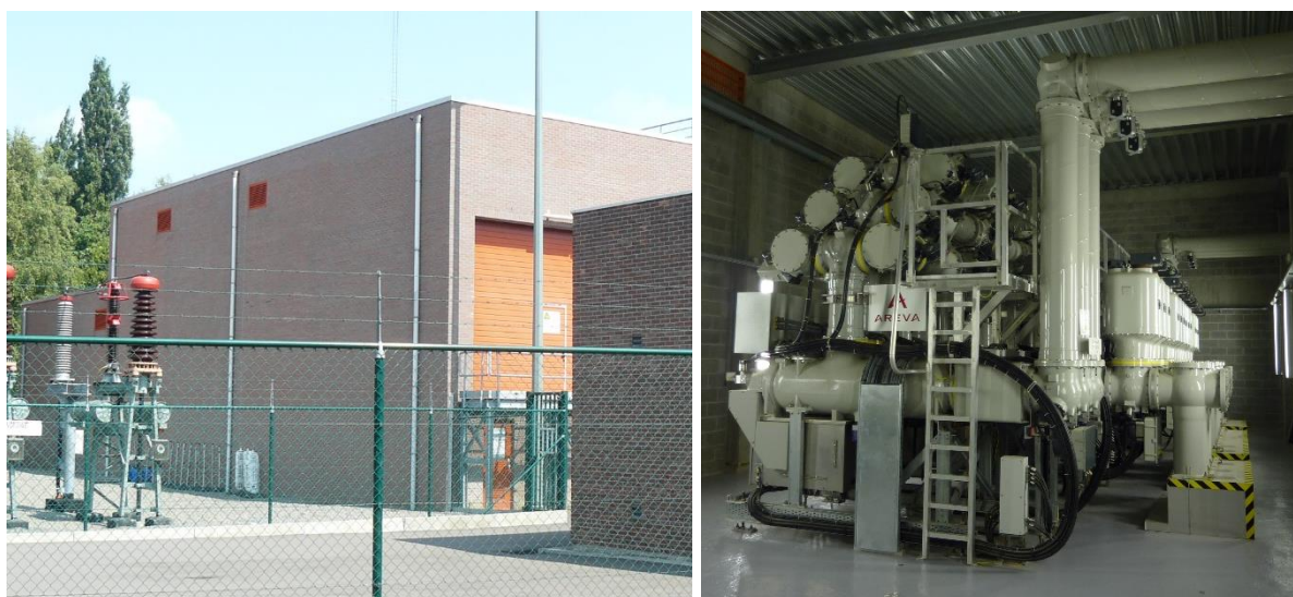
Figure 1.5 : sous-station 150 kV de type GIS
